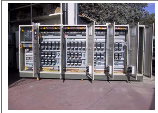
QUADRO POTENZA PER RISCALDAMENTO FORNO PRODUZIONE VETRO
