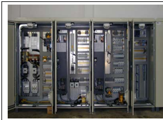
QUADRO AZIONAMENTI DA 1200 A SOLLEVAMENTO GRU
