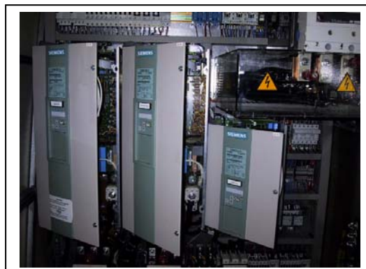
QUADRO INVERTER SINCRONIZZAZIONE MOTORI
