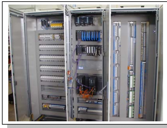
QUADRO PLC SIEMENS S7 400 IN BACK-UP IMPIANTO SCARICO GESSO SU NAVE
