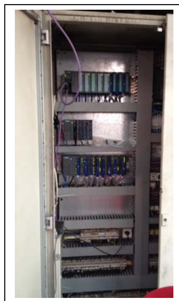
QUADRI P.L.C. S7-300 SIEMENS
