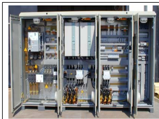
QUADRO INVERTER SIEMENS TRASLAZIONE GRU
